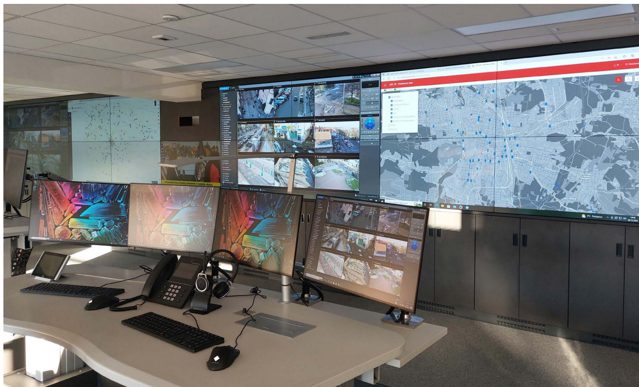
Dopravně informační a řídicí centrum České Budějovice
